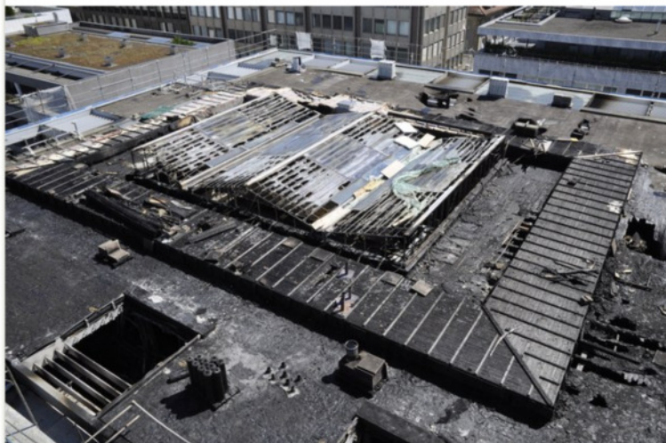
Das zerstörte Dach der Zuger Kantonalbank
